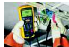
Test kabeláže v malé rozvodné skříni – vše v jednom bodě
