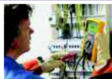
Test izolace na deskovém rozvaděči
